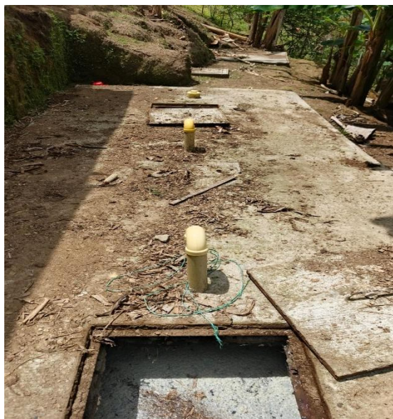
Fuente visita fiscal 27/04/26 Imagen N°11. Sistema de tratamiento (STARD) construido. Corregimiento de Arabia, Finca la lotería.
